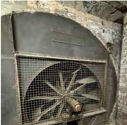
Air Fan in the Basement
